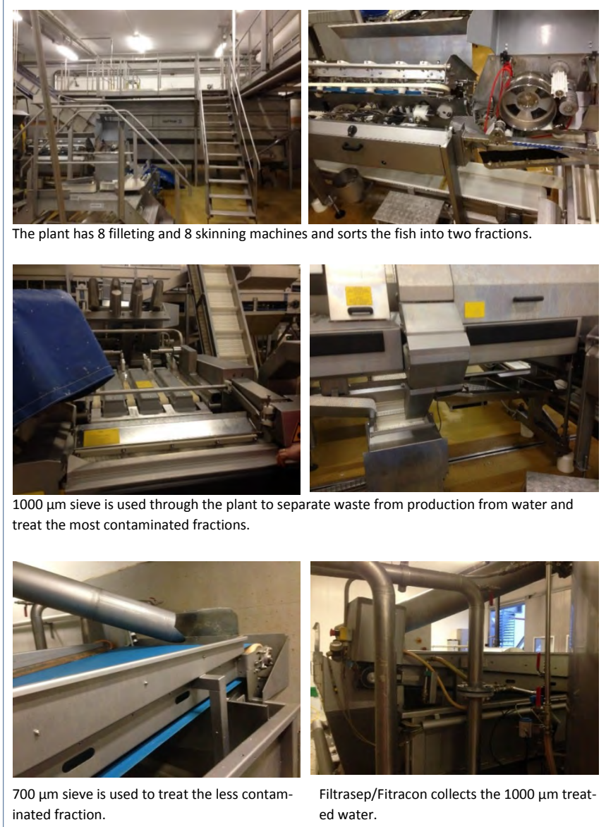
Figure 20. Pictures taken in the plant (Norway Pelagic AS, Måløy)
