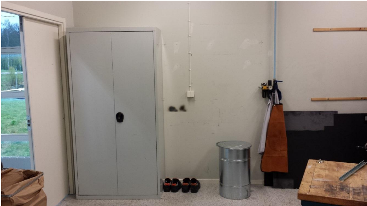
Figur 14. Bilden visar plåtskåp för förvaring av kemiska produkter.
