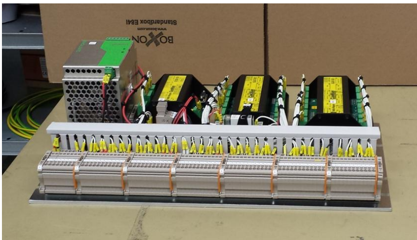
Figur 2. Bilden visar färdigmonterat elektronikskåp..
