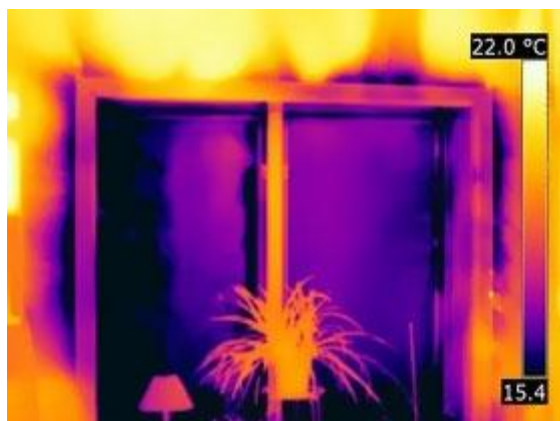
Figur 15: Termografering av ett fönster - köldbrygga[36].
