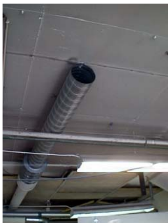
Bild 13. Frånluftsdon placerat under tak
