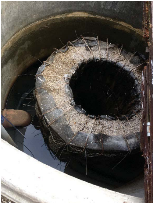
Figur 38. Exempel på hur ett kalkfilter i en brunn kan utformas, från projektet Supreme-Tech i Danmark (Foto: K. Tonderski).
