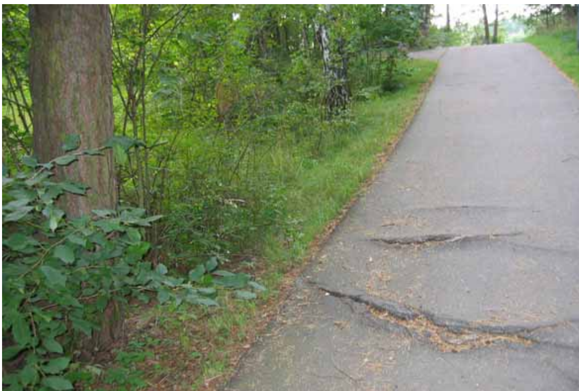
Figur 3 Illustration av problemet med rotinträngning på cykelvägar. Fotot är taget av författaren i Linköping, i september 2006.
