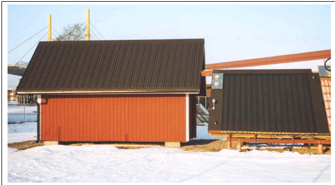
Figur 3.2: Installationer med EMA-solfångare vid SERC, Högskolan Dalarna.
