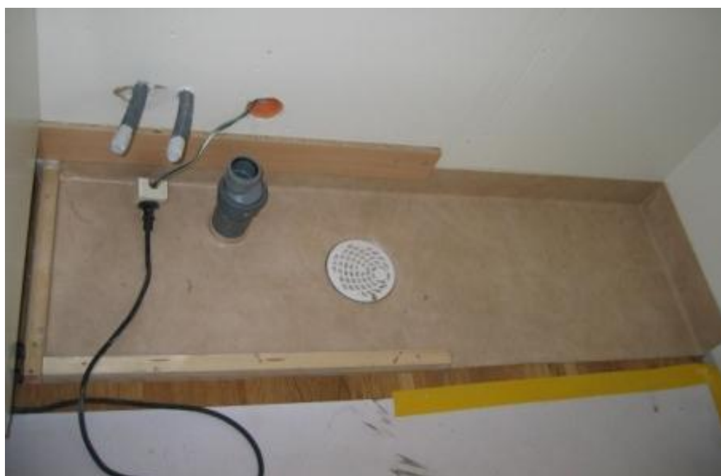
Figur 8.3. Kök med trägolv skarvat med plastmatta under diskbänksskåp. [27]
