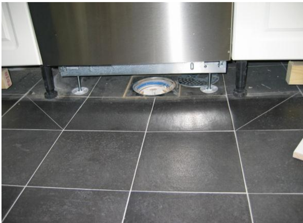
Figur 8.4. Kök med klinkergolv och golöbrunn under diskmaskin. [27]
