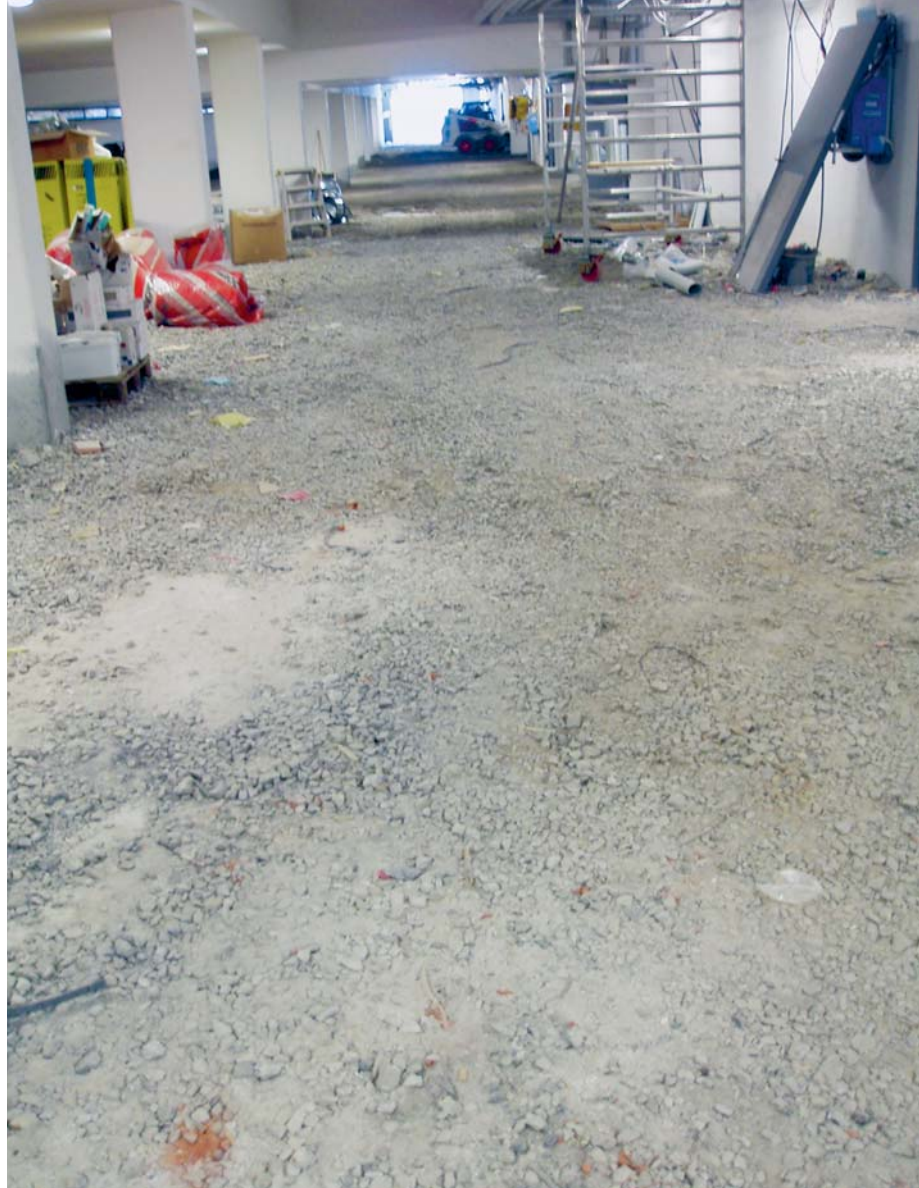
Det var tungt att transportera material på det ojämna underlaget mellan förråden och hissarna.
