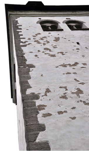
Fig. 17. Kyrktorn uppvisar ofta accelererade puts-skador orsakade av slagregn.
