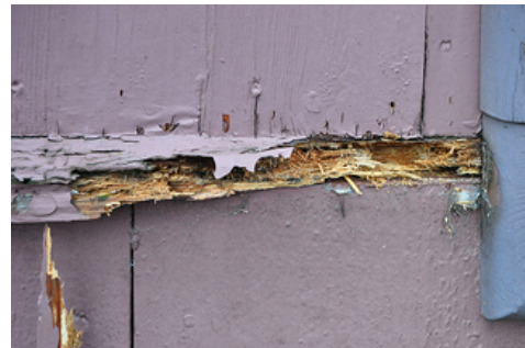
Plastfärgen har hållit kvar fukten i träpanelen och röta och insektsangrepp har uppstått under färglagret.
