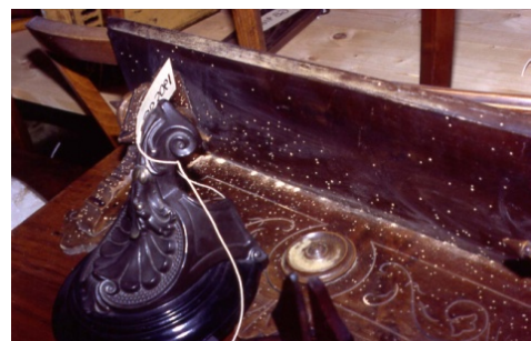
Förekomsten av trämjöl vid flyghålen indikerar att insektsangreppen (i detta fall av strimmig trägnagare) är färska och bör åtgärdas snarast. Foto: Lisa Nilssen.
